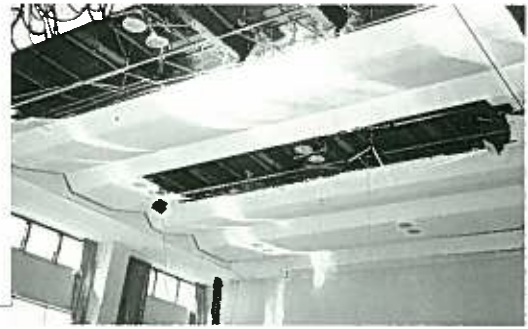
川口町公民館 天井ボード落下
